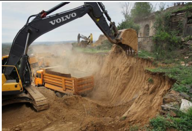
2014 年 7 月，山西省保德县同舟露天煤矿的挖掘机正在作业，农民祖祖辈辈赖以生存的土地被露天煤矿破坏。©邬海洋/Greenpeace
